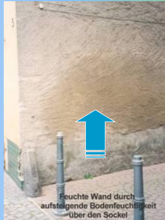
Feuchte Wand durch aufsteigende Boden- feuchtigkeit durch den Sockel
