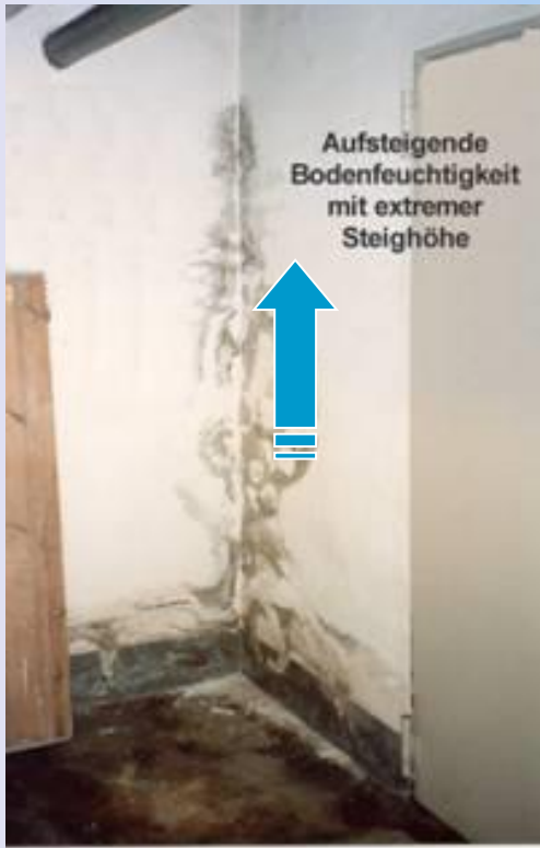
Aufsteigende Bodenfeuchtigkeit mit extremer Steighöhe
